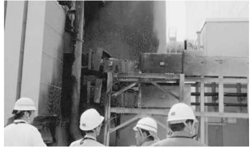
図2 支持台の沈下により、建物と変圧器を結ぶケーブルがショートし発火、変圧器の油に引火して火災となった。
