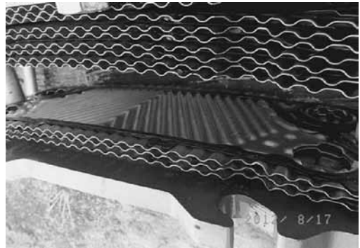
写真-4 鉄分52mg/L、酸素遮断地下水を282日間運転後のプレート式熱交換器 新品同様
